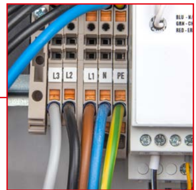
Anschluss 3-phasige Zuleitung (L3, L2, L1, N, PE)
