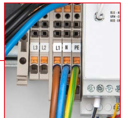
Anschluss 1-phasige Zuleitung (L1, N, PE)
