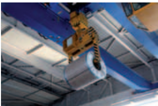
Anwendungsbereich Kran- und Hebeteknik
