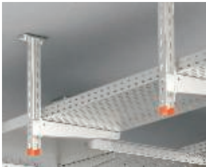
Gesamtmontage einer Deckenbefestigung Darstellung einer fertigen Deckenmontage mit Kabelrinnen.
